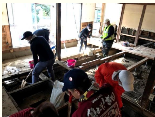
床下の泥のかき出し
